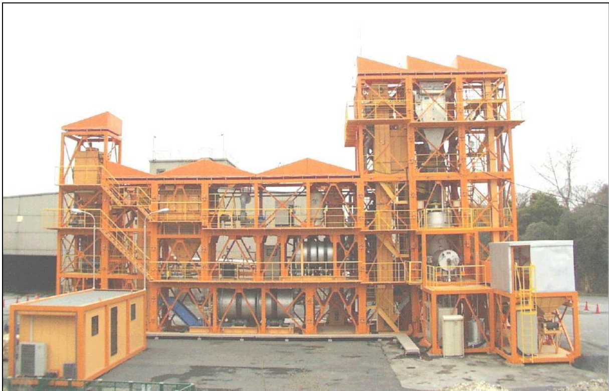
Fig. 4. Unitate mobila de reciclare a deseurilor de constructii rezultate din beton ( vedere de ansamblu )
